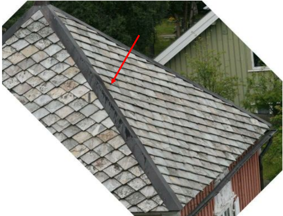
Røros. Hjortkappellet. Hovedtak syd. Stabiliteten til skiferen omkring det partiet som er merket bør sjekkes.
