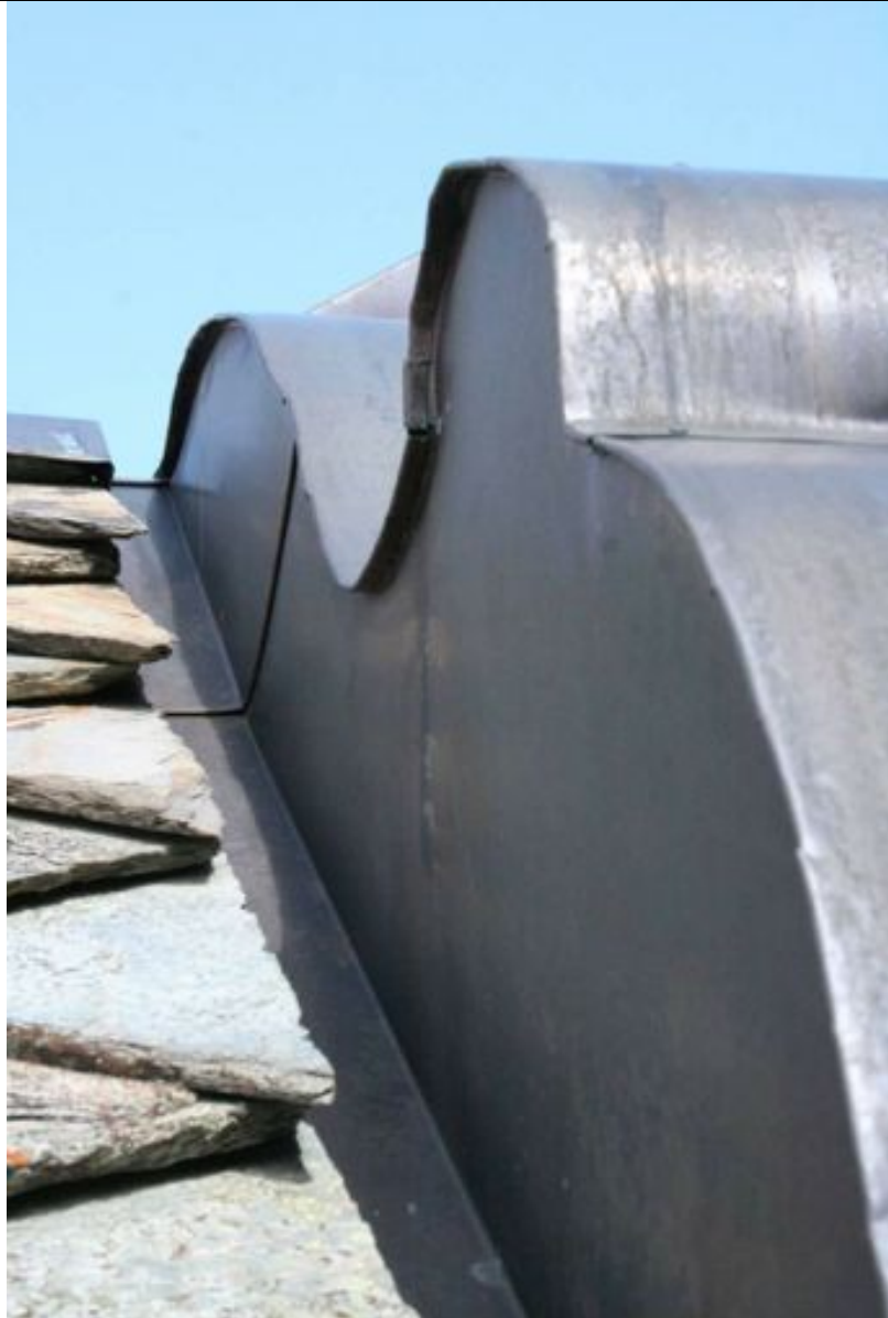
Samme beslag som bildet over. Beslaget er forholdsvis grovt tilpasset.
