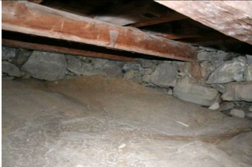
Gravkjelleren. Spor i sanden viser hvor vannet renner i bekker gjennom rommet.
