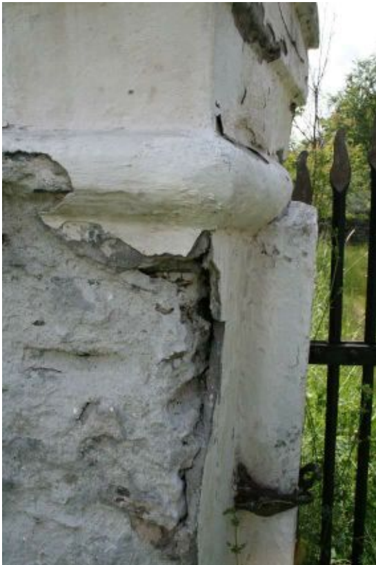
Detalj av skader på tre av portstolpene.
