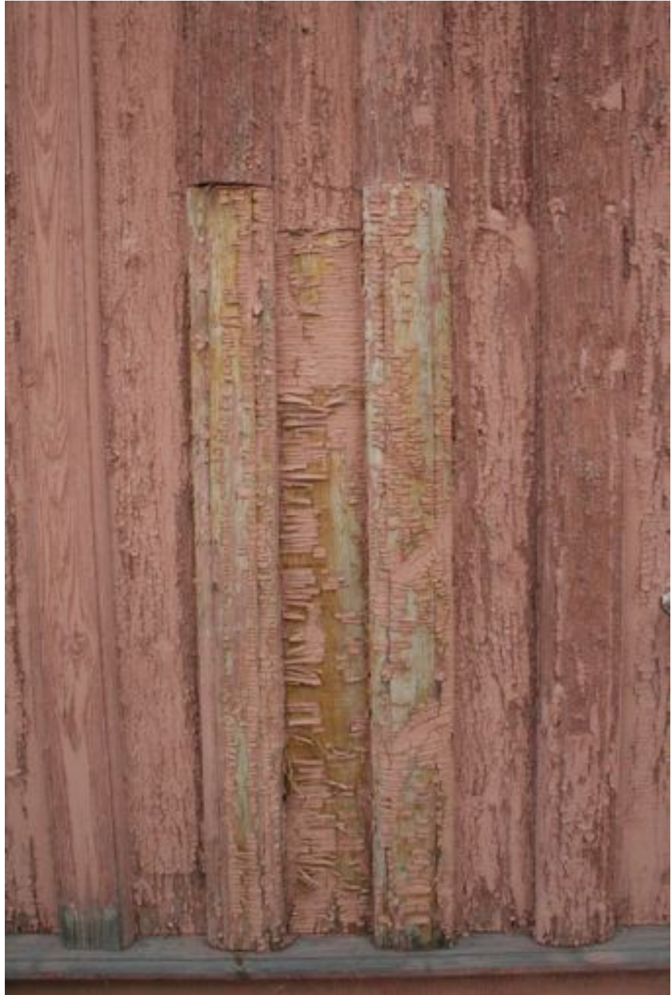
Panel på østveggen. Store skader i malingslagene. Skadene har oppstått både på det opprinnelige og det nye panelet.
