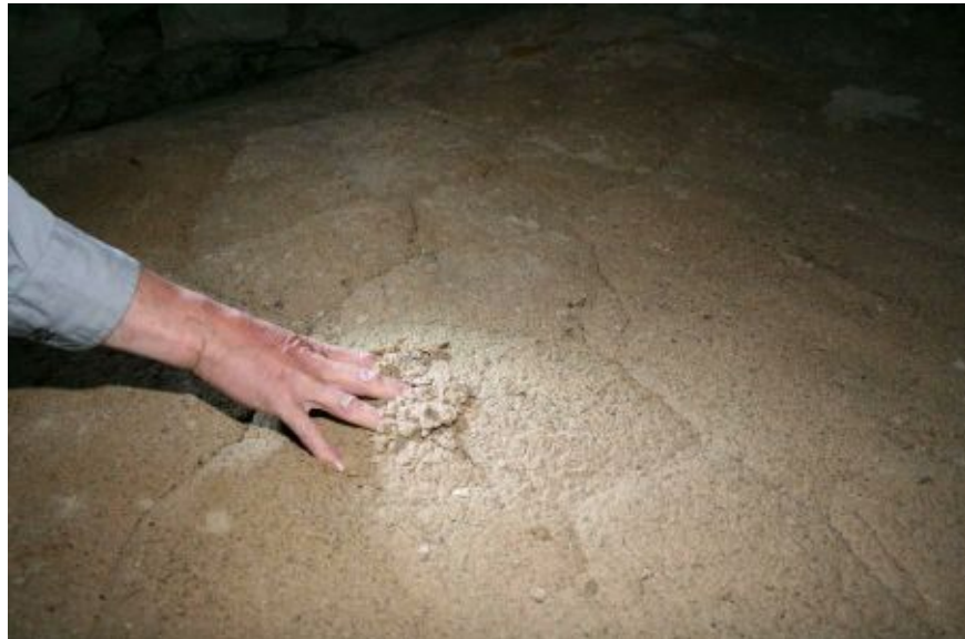
Sanden har meget høyt fuktinnhold.
